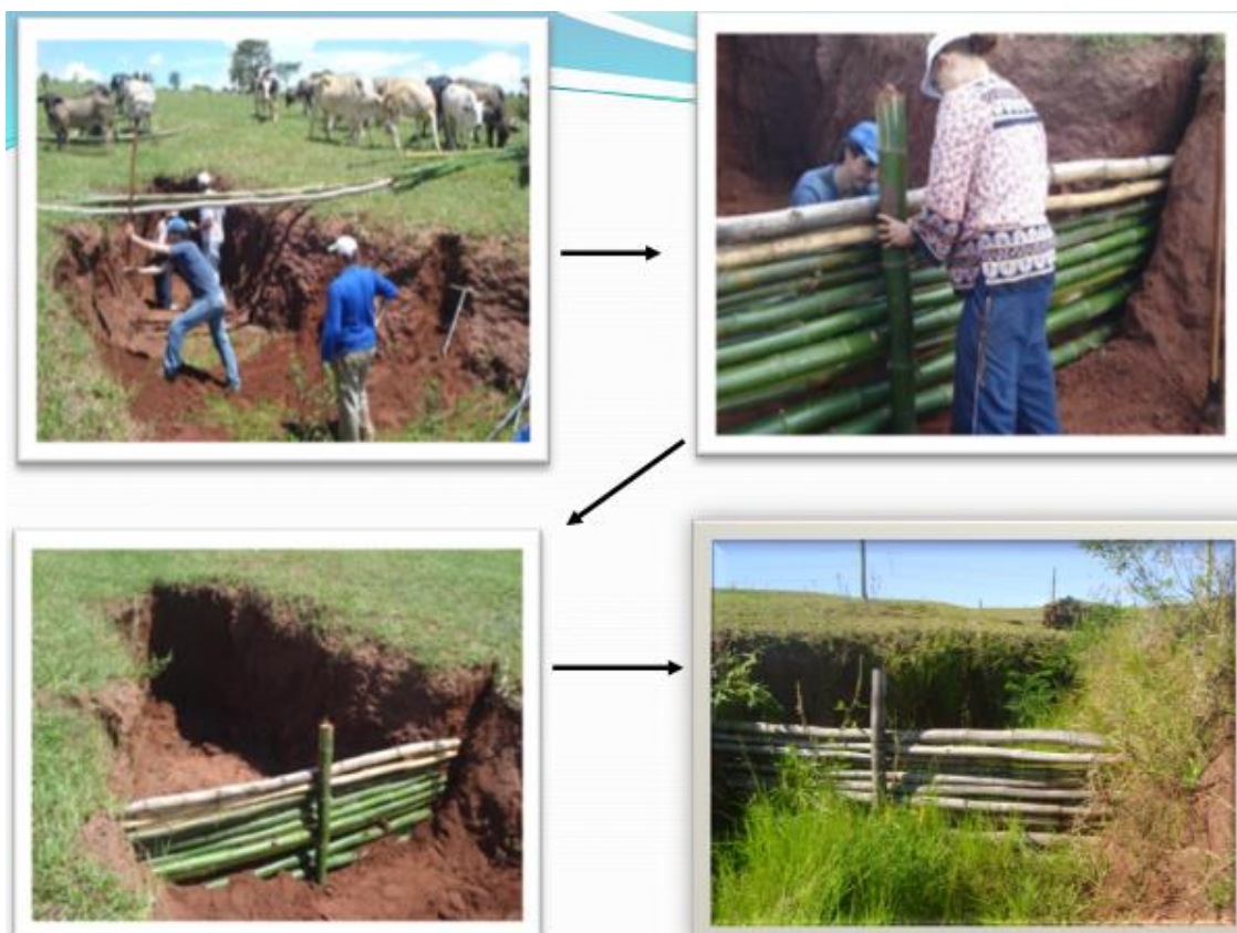
Figura 4: Implantação de técnicas de bioengenharia em erosão linear no Assentamento Nova Esperança, município de Euclides da Cunha, SP
